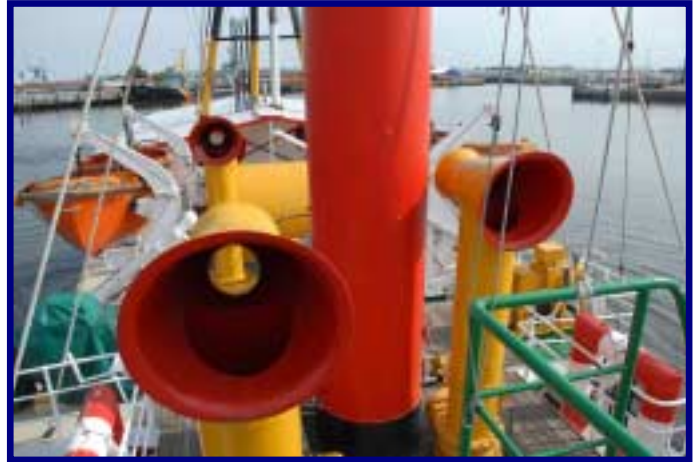
Des impressionnantes bouches d'aération dominant le pont.
